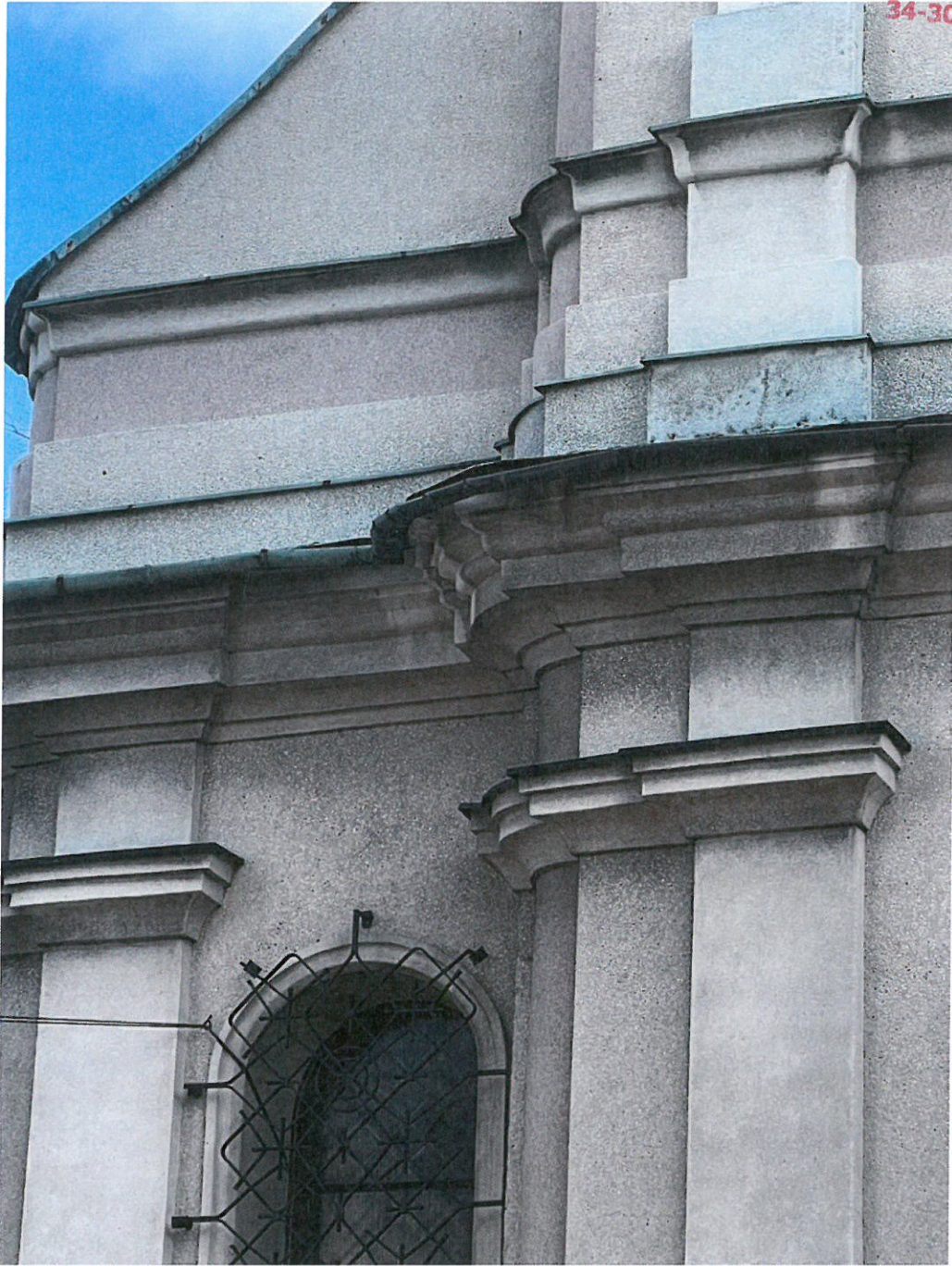
Fot. nr 20 Kościół p. w. św. Marcina w Radziechowach, k. XIV/XV w. Widok fragmentu fasady; strona zachodnia. Widoczna faktura tynków cementowych, zawilgocenie na skutek nieszczelności obróbek blacharskich, zabrudzenia, nalot fałszywej patyny.
