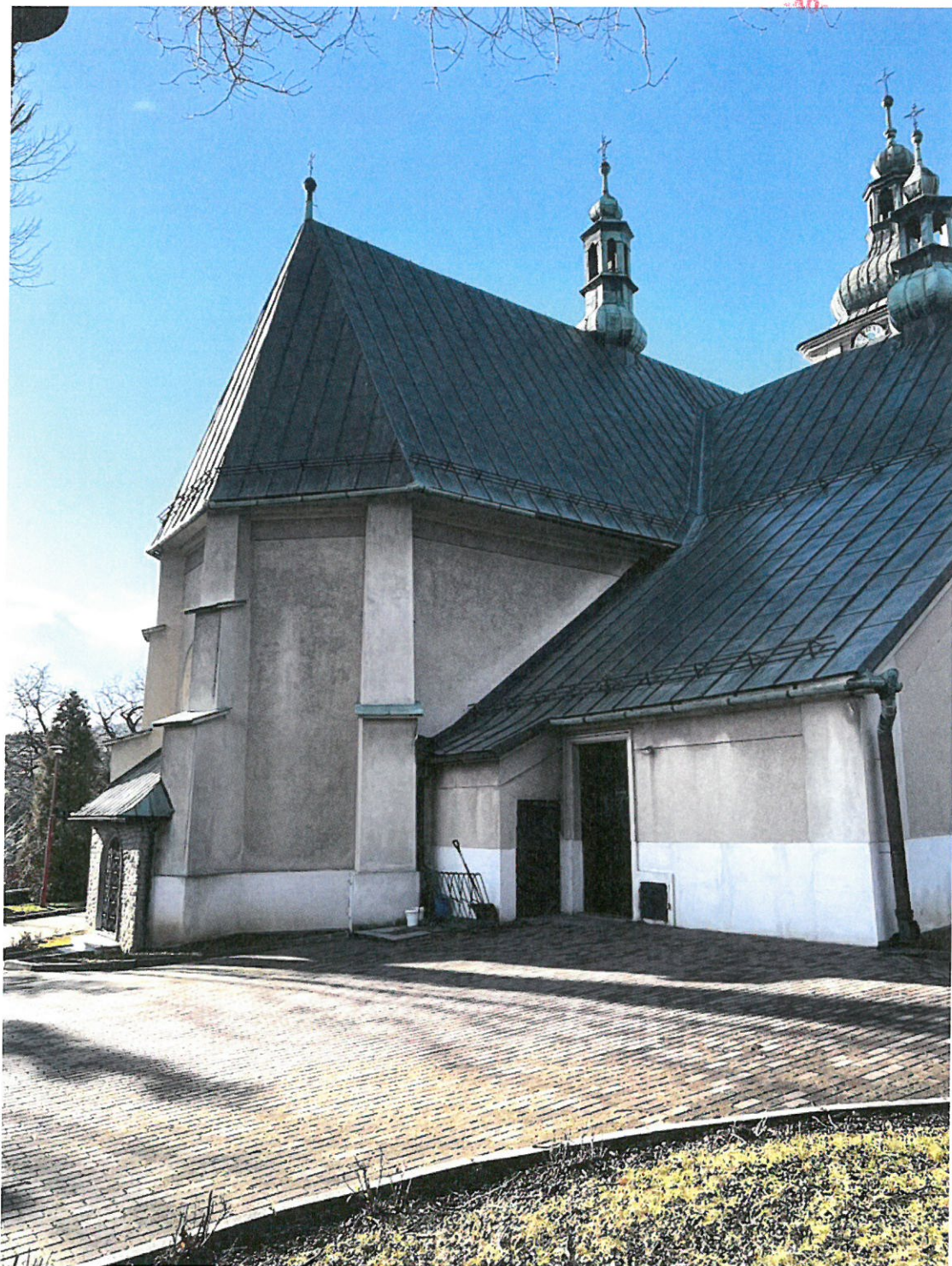
Fot. nr 9 Kościół p. w. św. Marcina w Radziechowach, k. XIV/XV w. Widok ogólny od strony wschodniej. Widoczna gruba warstwa cementowego tynku płukanego, zacieki powstałe na skutek nieszczelności obróbek blacharskich i rynien, ogólne zabrudzenie, nalot fałszywej patyny oraz siatka rys skurczowych i pęknięć. Widoczne tynki renowacyjne w strefie cokołowej wykonane w ramach wcześniejszego remontu.
