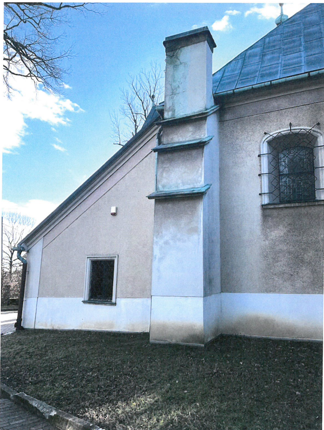
Fot. nr 7 Kościół p. w. św. Marcina w Radziechowach, k. XIV/XV w. Widok ogólny od strony północnej. Widoczna gruba warstwa cementowego tynku płukanego, ogólne zabrudzenie, nalot fałszywej patyny oraz siatka rys skurczowych i pęknięć. Bardzo zły stan zachowania tynków na powierzchni komina, na skutek nieuszczelnionych obróbek blacharskich. Widoczne tynki renowacyjne w strefie cokołowej wykonane w ramach wcześniejszego remontu.
