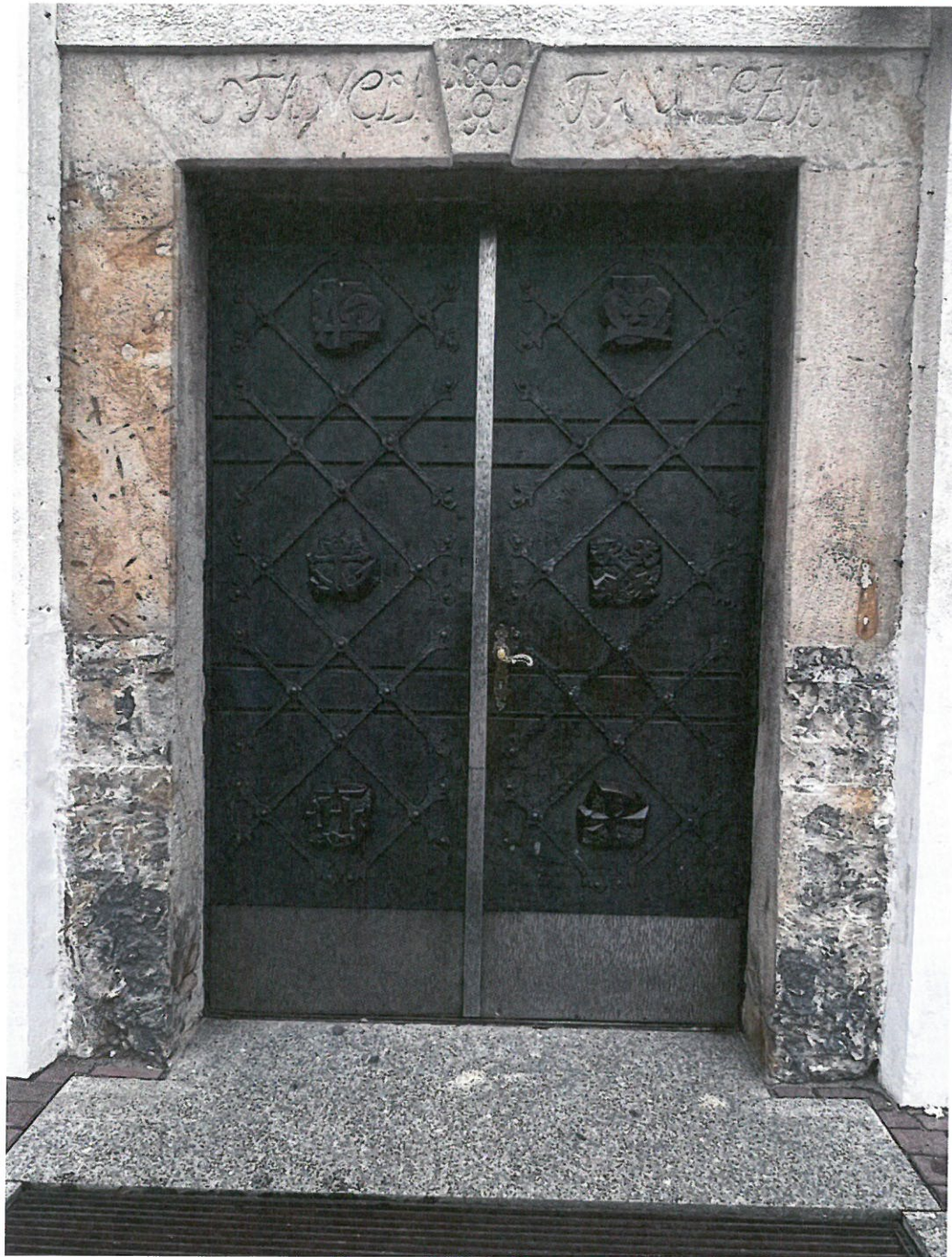
Fot. nr 23 Kościół p. w. św. Marcina w Radziechowach, k. XIV/XV w. Drzwi i portal kamienny; wejście główne. Widoczny zły stan zachowania kamienia w dolnych partiach portalu: obicia, złuszczenia, rozwarstwianie i osypywanie się kamienia, zabrudzenie.
