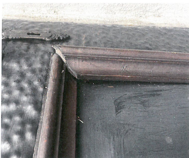
Fot. nr 29 Fot. nr 30 Kościół p. w. św. Marcina w Radziechowach, k. XIV/XV w. Drzwi od strony wschodniej - na ścianie prezbiterium. Widoczne objawy korozji i zabrudzenie blachy, rozszczelnienia drewnianych listew.
