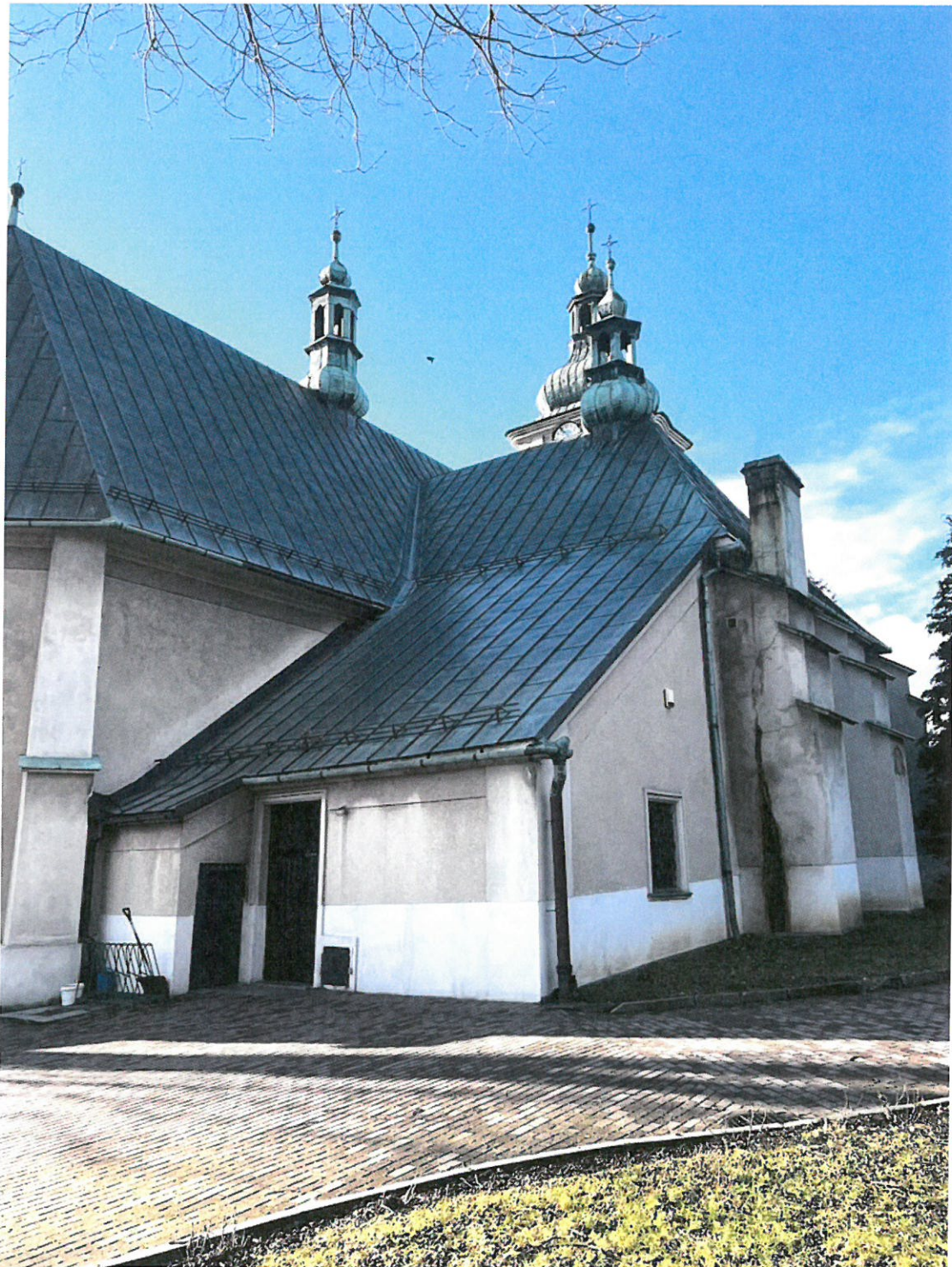
Fot. nr 8 Kościół p. w. św. Marcina w Radziechowach, k. XIV/XV w. Widok ogólny od strony północno-wschodniej. Widoczna gruba warstwa cementowego tynku płukanego, zacieki powstałe na skutek nieszczelności obróbek blacharskich i rynien, ogólne zabrudzenie, nalot fałszywej patyny oraz siatka rys skurczowych i pęknięć. Bardzo zły stan zachowania tynków na powierzchni komina. Widoczne tynki renowacyjne w strefie cokołowej wykonane w ramach wcześniejszego remontu.
