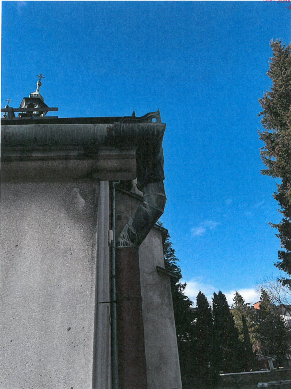
Fot. nr 22 Kościół p. w. św. Marcina w Radziechowach, k. XIV/XV w. Widok od strony północnej. Widoczne nieszczelności obróbek blacharskich, skorodowana rynna, zacieki i zabrudzenia na powierzchni elewacji.
