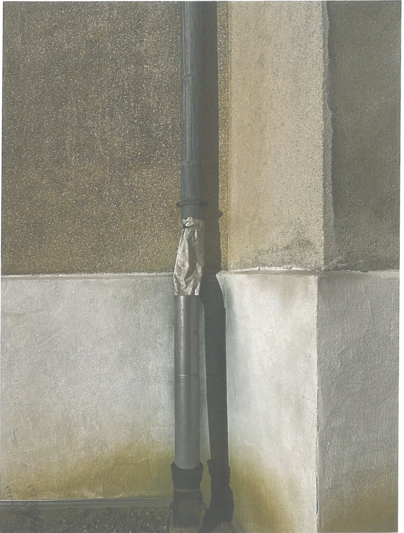
Zdjęcie 8. Widok na nieodpowiednie połączenie elementów instalacji deszczowej
