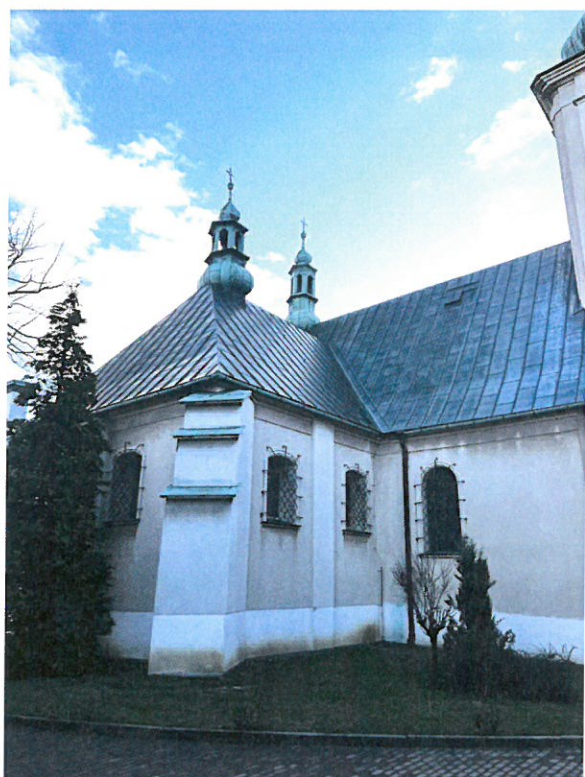
Fot. nr 3 Fot. nr 4 Kościół p. w. św. Marcina w Radziechowach, k. XIV/XV w. Widok ogólny od strony północno-zachodniej. Widoczne zacieki, zawilgocenie tynków z powodu nieszczelnych obróbek blacharskich, ogólne zabrudzenie oraz siatka rys skurczowych i pęknięć. Widoczne tynki renowacyjne w strefie cokołowej wykonane w ramach wcześniejszego remontu.
