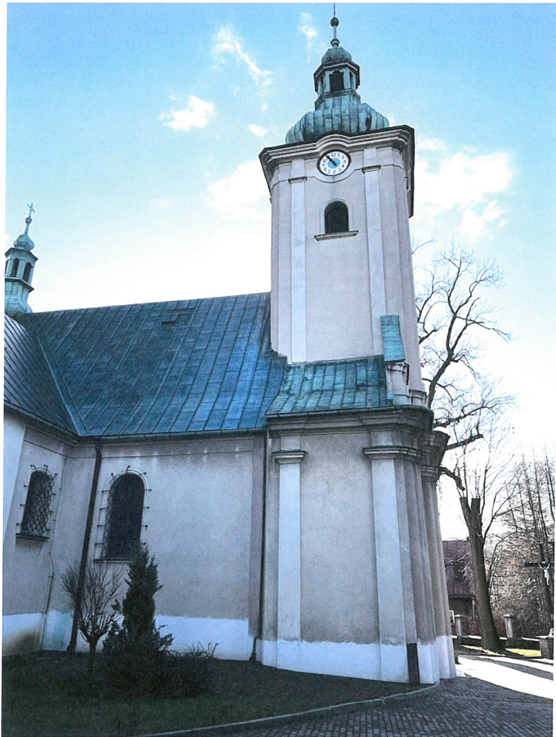
Fot. nr 2 Kościół p. w. św. Marcina w Radziechowach, k. XIV/XV w. Widok ogólny od strony północno-zachodniej. Widoczne zacieki, zawilgocenie tynków z powodu nieszczelnych obróbek blacharskich, ogólne zabrudzenie oraz siatka rys skurczowych i pęknięć. Widoczne tynki renowacyjne w strefie cokołowej wykonane w ramach wcześniejszego remontu.
