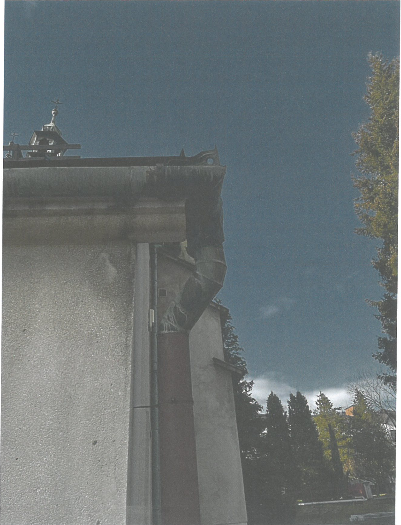
Zdjęcie 9. Widok na zawilgocony fragment narożnika gzymsu na styku instalacji deszczowej
