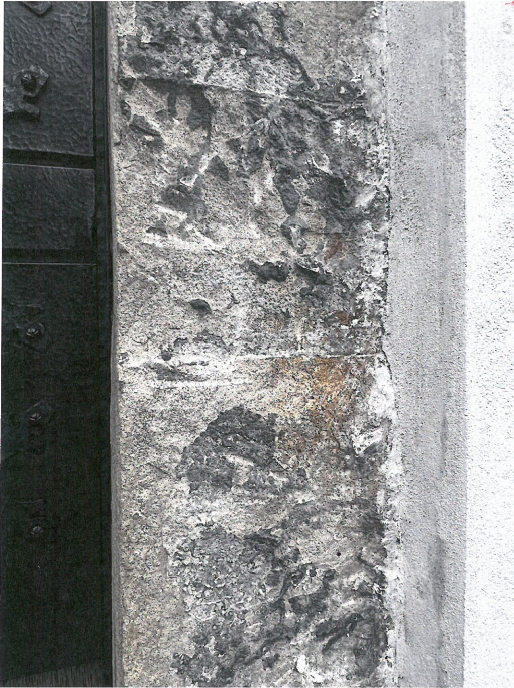
Fot. nr 25 Kościół p. w. św. Marcina w Radziechowach, k. XIV/XV w. Fragment portalu kamiennego wejścia głównego. Widoczny zły stan zachowania kamienia – obicia, złuszczenia, rozwarstwianie i osypywanie się kamienia.
